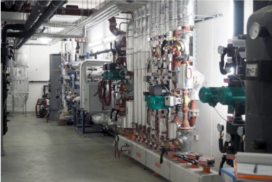
Abbildung 1: In den komplexen Heizzentralen stecken oft viele Effizienzpotenziale, die im Rahmen eines Audits gefunden werden können. (Quelle: e7)
